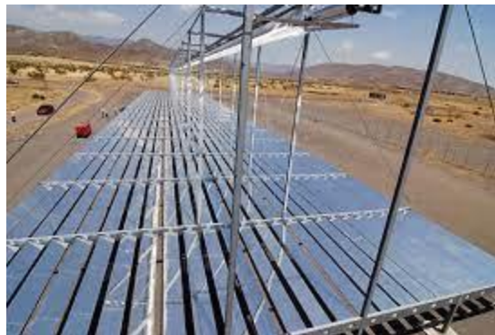
Ilustración 2.21 Imagen de un concentrador de Fresnel. Fuente: Laboratorio Nacional de Sistemas de Concentración Solar y Química Solar, 2015
