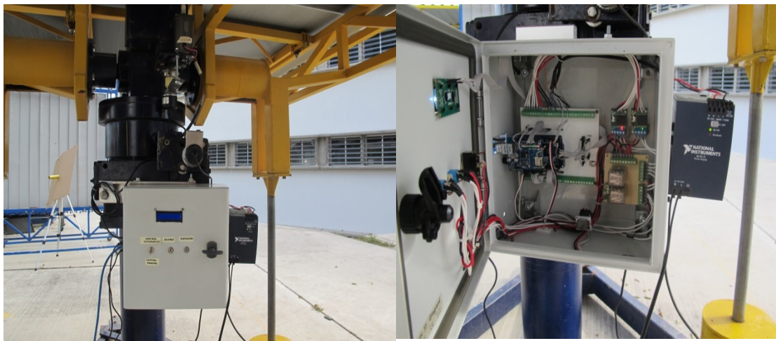
Figura 4. 17 Instalación completa del sistema de control sobre el mini helióstato.
