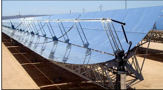
Figura 2. Sistema de canal parabólico.
