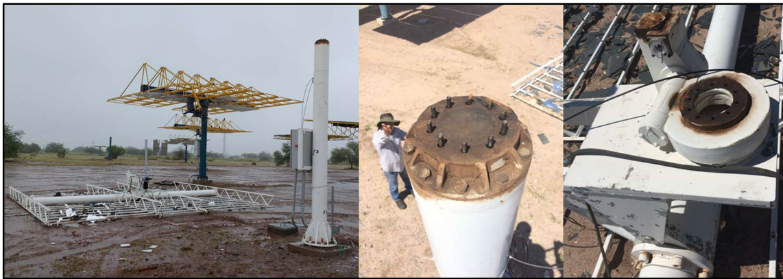
Figura 9. Daños en heliostato debido al huracán Newton.
