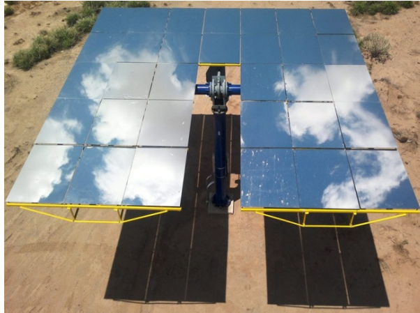
Figura 5.1: Helióstat de 37.44 m 2 ubicado en la posición N2 (CETOC,2013).
